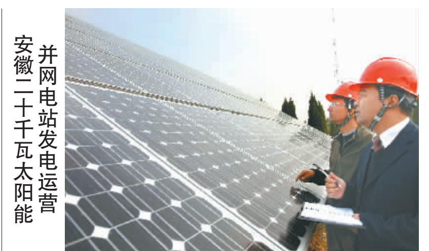
11月18日,安徽省首座20千瓦太阳能并网电站在巢湖110千伏枞皋变电站所发电运营,年均可发电3万千瓦以上。这一项目是安徽省电力公司开发新能源的试验、示范项目,2009年将在全省各变电站逐步推广。新华社发
